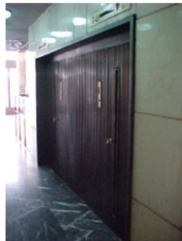
φωτ.3 – ασανσέρ πολυκατοικίας
